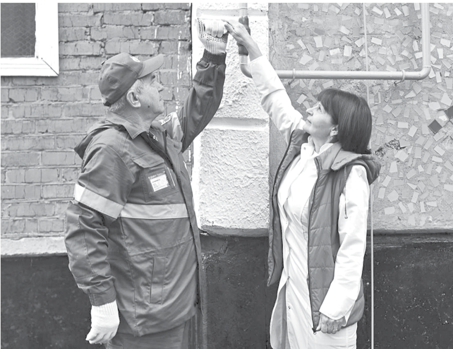
Газовый вентиль открыли заведующая медучреждением фельдшер Ирина Соколова и слесарь «Газпром газораспределение Майкоп» Сергей Конев.
